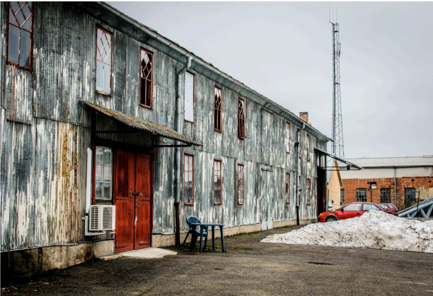
Arboga, Sverige. Fastighet vid Norra Ågatan med renoveringsbehov.
